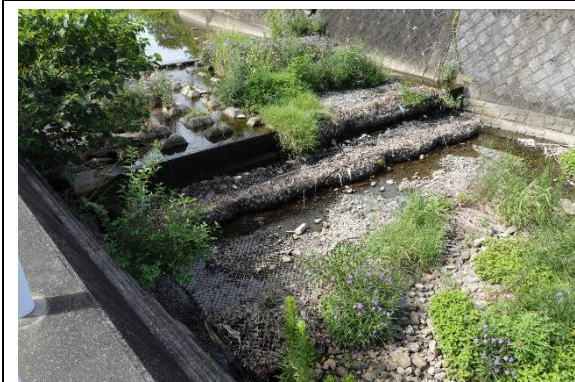
⑲時津川下流側段差の蛇籠(8/2 撮影)
